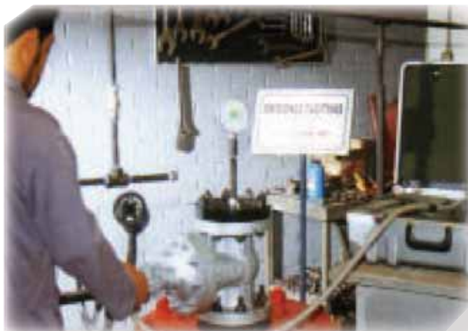
Equipos de medición e instalaciones para gas hielo y metano
